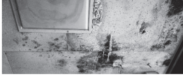
玄関の天井に雨漏りのしみとカビ
