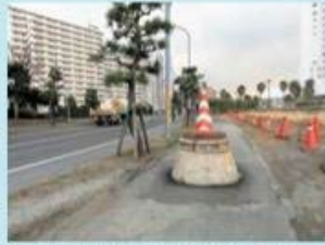
マンホールの浮き上がり（東日本大震災） 写真：独立行政法人土木研究所
